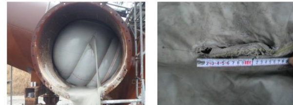
図4 閉止補助材の破断
