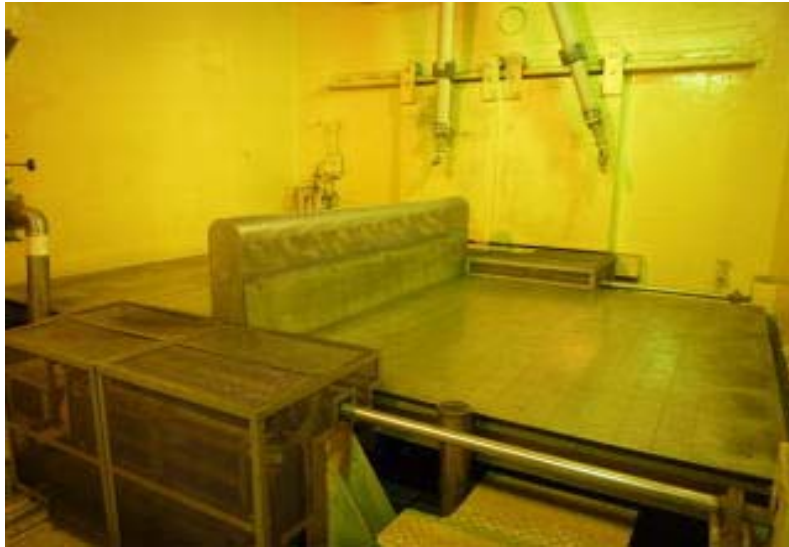
放射線照射設備
